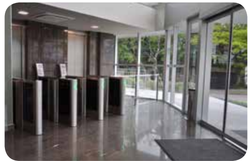
Bloqueio dGate instalado em um edifício comercial em Porto Alegre, Rio Grande do Sul.
